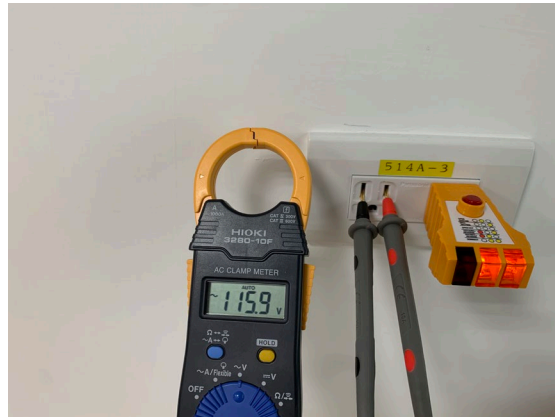
源插座裝設完成， 電壓檢視 及相序 及 極性測試 (蓋板上方貼迴路標 籤)
