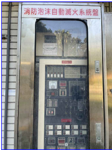
原集液井Call報訊號係連動消防泡沫自動滅火系統(廢除)
